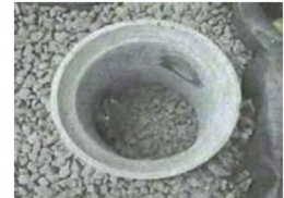
雨水浸透ます
